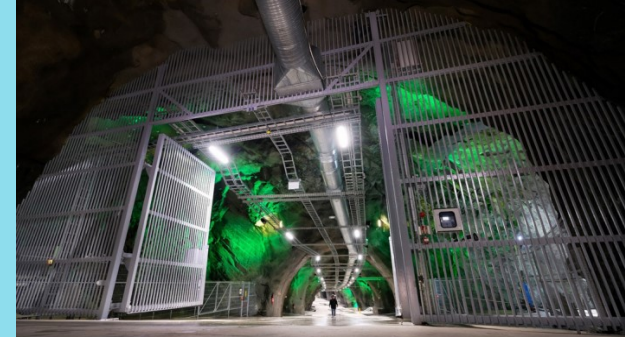
BEREKRATIG DATALAGRING: Vestlandet har eit unikt utgangspunkt for å bli verdens mest attraktive dataserterregion. Vi har overskudd på fornybar energi, låge strømprisar, god digital infrastruktur og eit kjølig klima. Foto: Lefdal Mine Datacenter.
